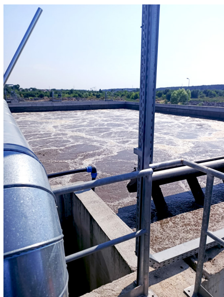
■ Stație de epurare a apelor uzate în Buftea (sursa: imagine surprinsă pe parcursul vizitei pe teren, realizată de evaluatori)
